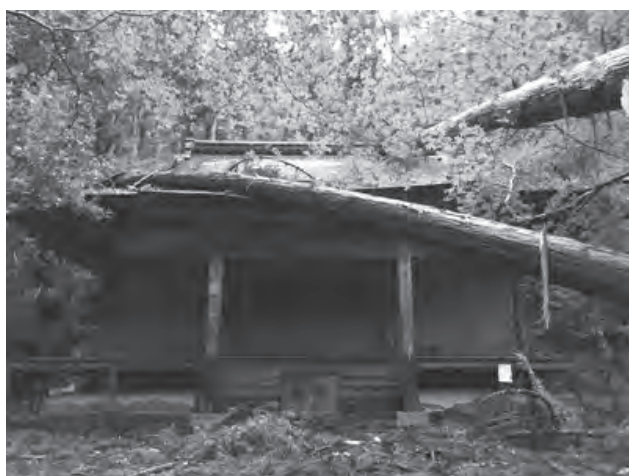
図1 台風21号の被害にあった高山寺金堂 [1]
