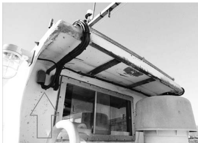
図 26 船室から船外への配線穴
