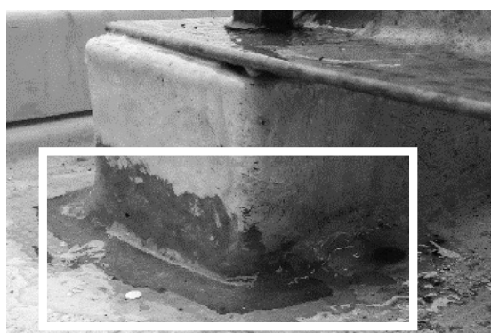
図 25 ドラムウインチの土台の FRP の割れを補修
